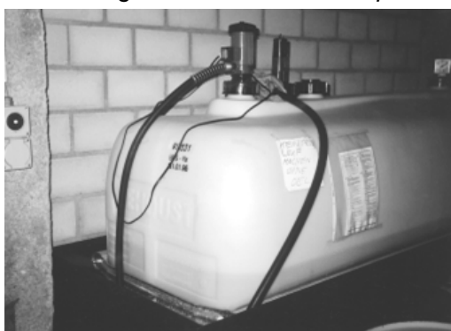
Kleintank mit elektrischer Pumpe
